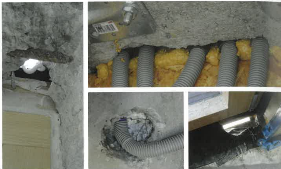
Slika 2: Zagotavljanja zrakotesnosti: na levi strani je prikaz neprimerno pripravljene odprtine za vgradnjo okna in nepravilnega tesnjenja oken s tesnilno maso. Srednji sliki prikazujeta nestrokovno tesnjenje prebojev električne napeljave. Na desni strani je prikaz nepremišljene rešitve detajla vgradnje balkonskih vrat - vir: GI ZRMK
