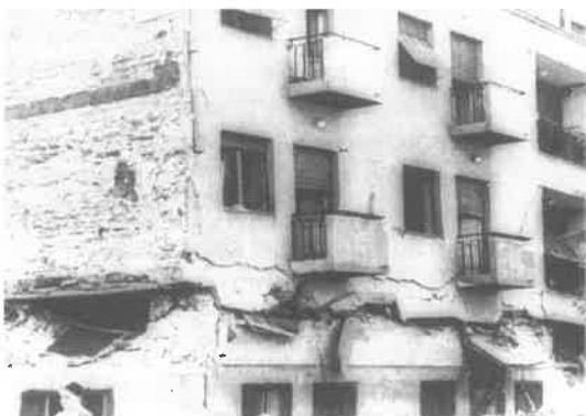
Skopje, 1963. Šibki zidovi pritličja v vzdolžni smeri večnadstropnega stanovanjskega bloka so se med potresom porušili (arhiv ZAG)
